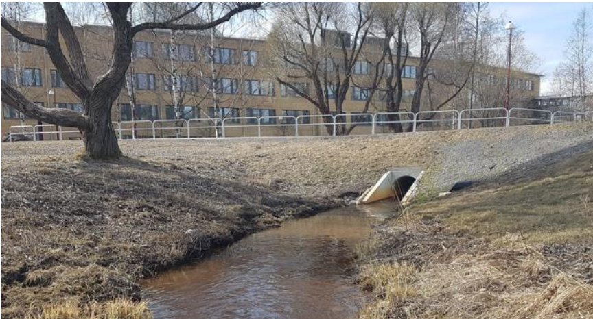
Figur 19: Flödesreglerande utloppstrumma under GC-vägen uppströms MIT-huset, som även utgör invallning av magasinet.
