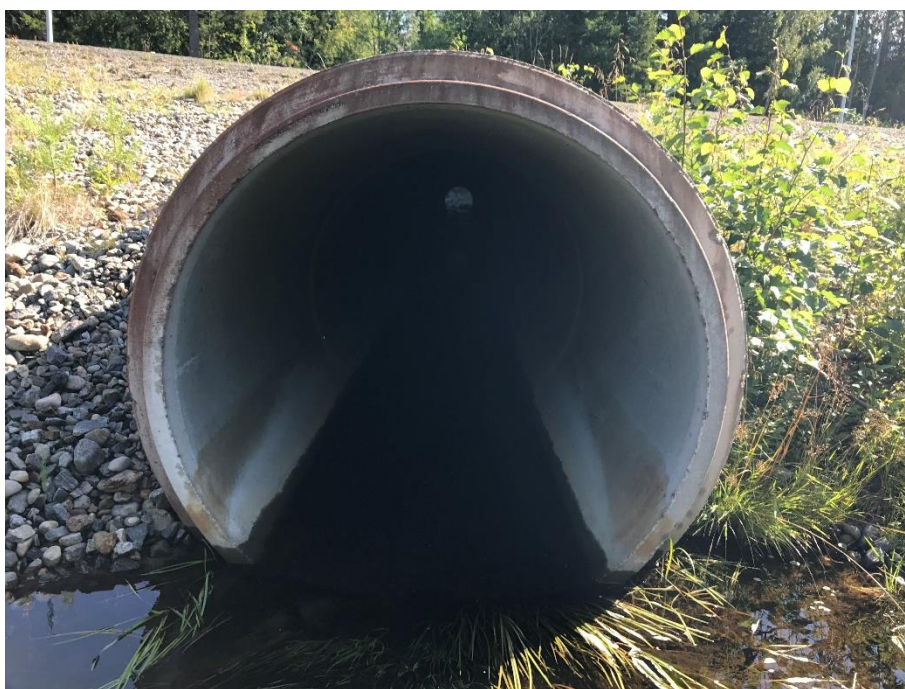
Figur 27. Vägtrumma med en del sten i. Den bör inte utgöra något hinder för fiskvandring.
