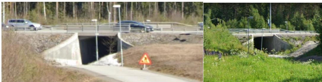
Dagens GC-tunnelutformning, till vänster under E4 och till höger under Tomtebovägen (Google streetview)
